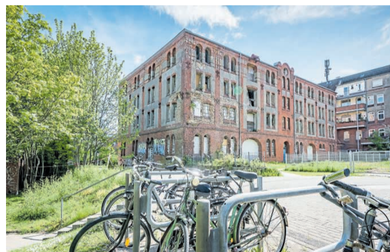
Derzeit nicht mehr als eine Ruine: der 1905 erbaute Haß-Speicher am Schwedendamm in Kiel. FOTO: FRANK PETER
